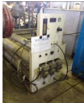
氮氣分離裝置
