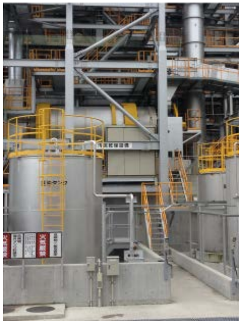
污泥乾燥設施
