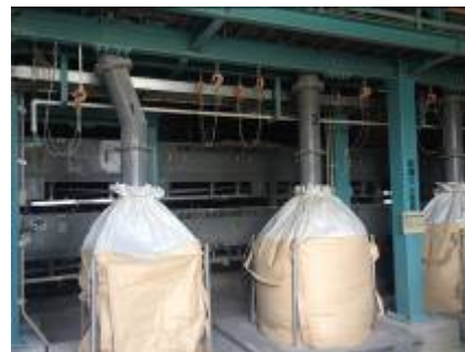
磷酸鹽乾燥設備
